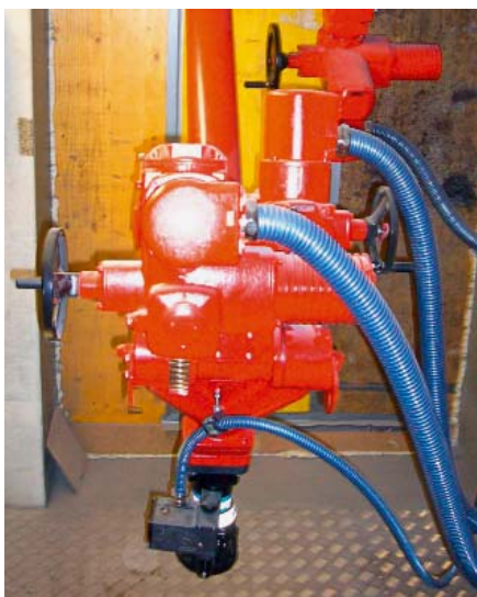
Löschanone im Bunker
