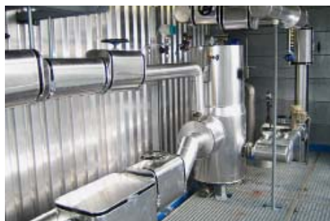
Dampfgaswärmung in der KVA Horgen
