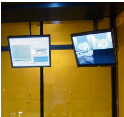
Anzeigemonitore in der Leitwarte
