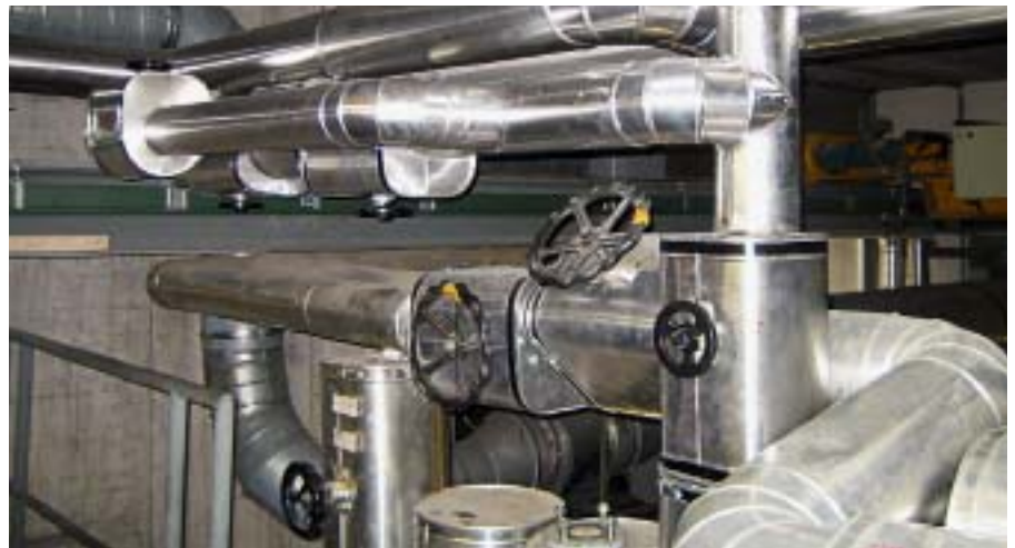
Dampf- und kondensatseitige Einbindung in die bestehende Anlage
